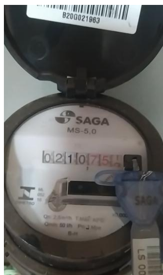
Figura 9 - Hidrômetro de água fria de um dos apartamentos.
