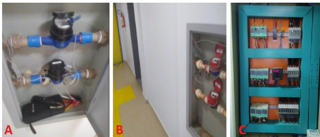
Figura 21 - Hidrômetros de água fria (A) e quente (B), e painel de concentração e registro dos consumos (C).
