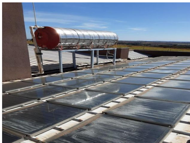
Figura 7 - Boiler e placas do SAS.
